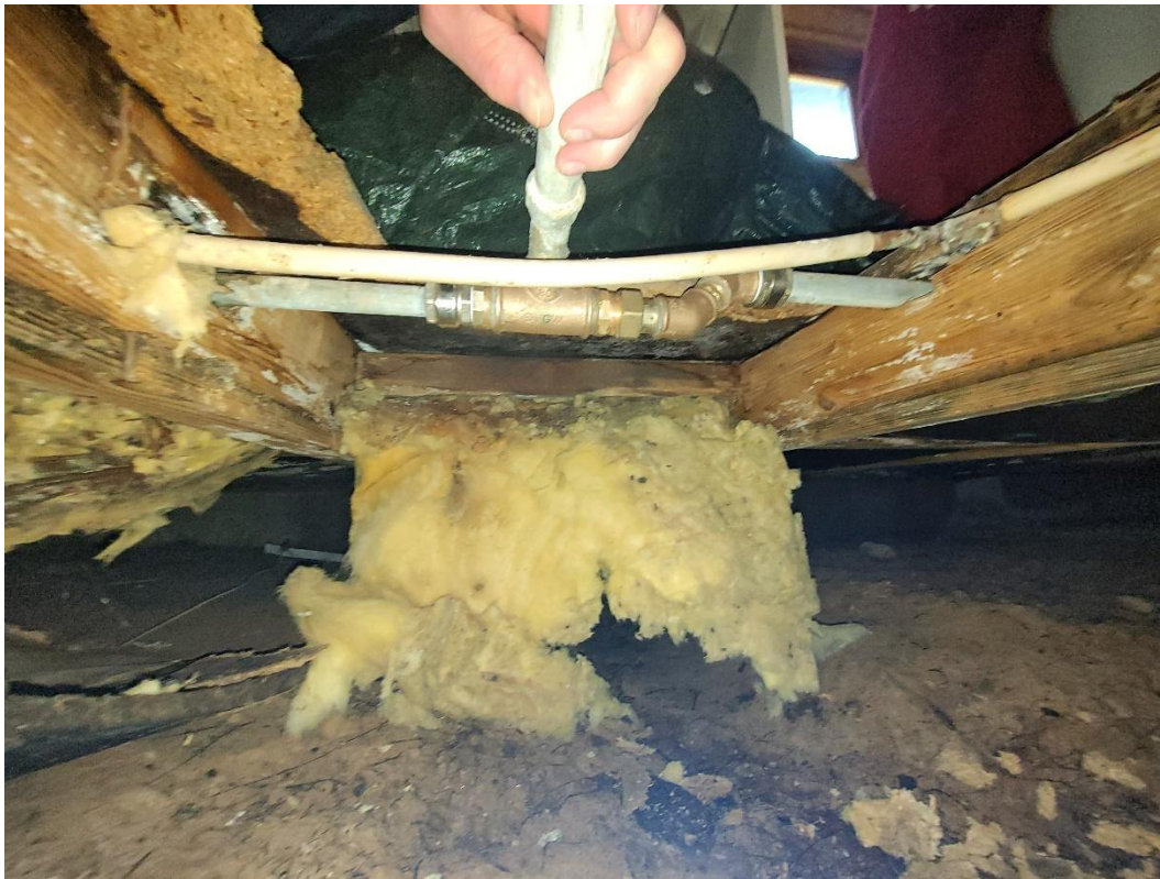
Holzschäden: Bodenunterseite / Holzschwamm
