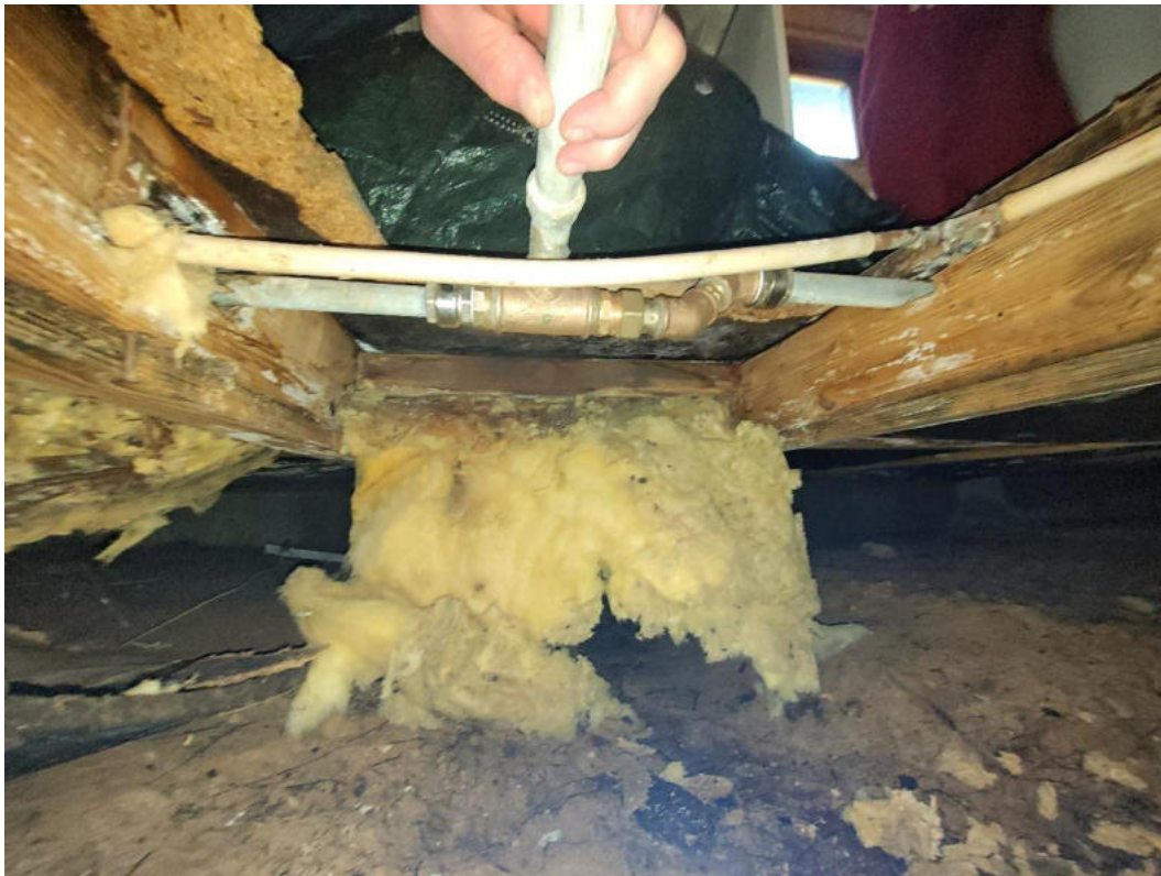
Holzschäden: Bodenunterseite / Holzschwamm
