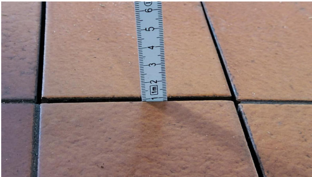
Küche: aufgewölbter Boden Nähe Flur / Rissbildung der Bodenfliesen
