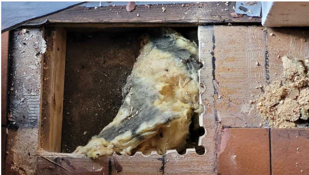
Küche : Boden zum Flur / Schimmelbildung auf der Unterseite der Dämm-Matten
