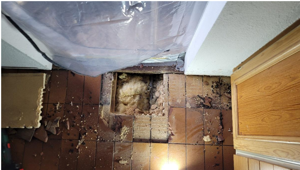
Geöffnete Schadensstellen: Küche / Folientüre zum Flur (→ siehe auch „Küche“)
