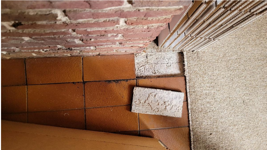
Küche: gelöste Bodenfliesen (Nähe Übergang zum Esszimmer)
