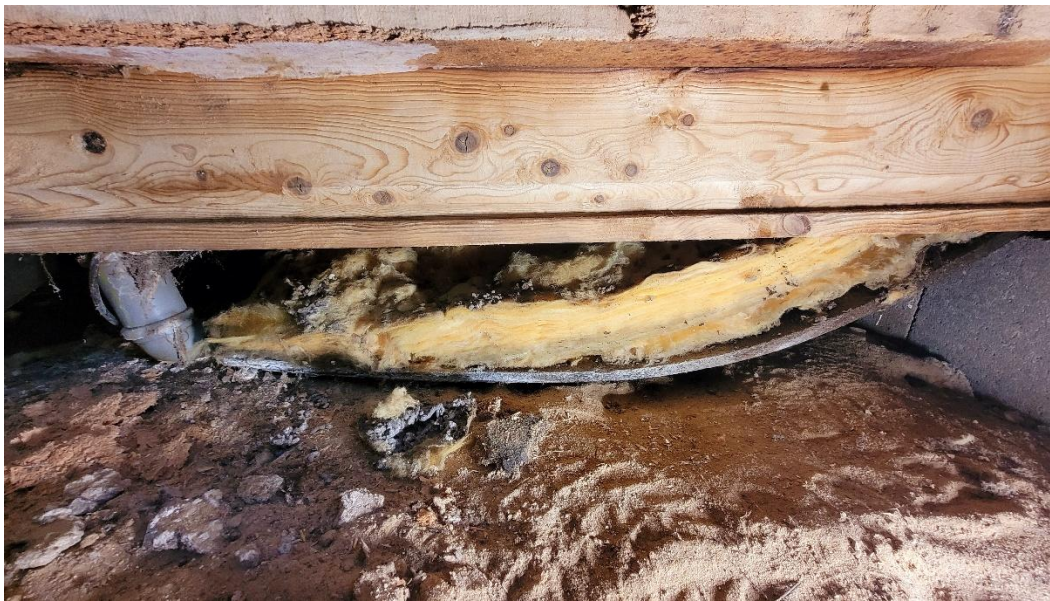
Schlafzimmer: Mycelbelag, herunterhängende Bodenplatte und Dämm-Matten
