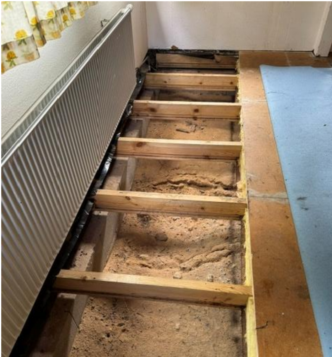
Essbereich: Schimmel auf der Unterseite der Dämmung / Erdreich mit Wasserlaufspuren
