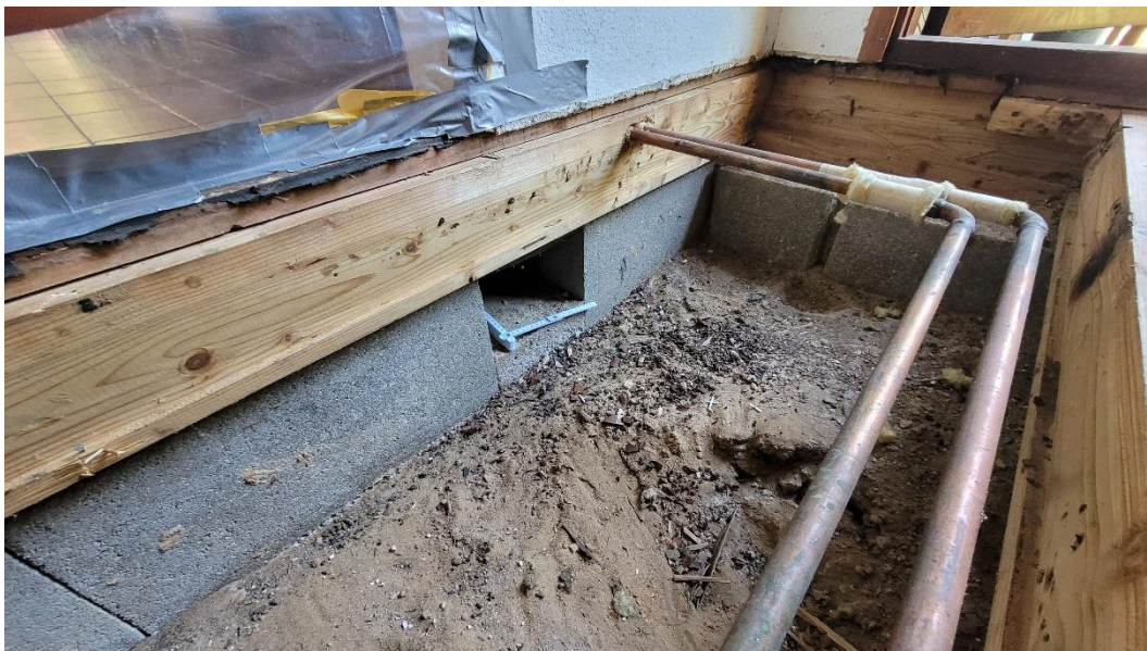
Geöffnete Schadensstellen: links Zugang zur Küche + Durchlässe in den Fundamenten
