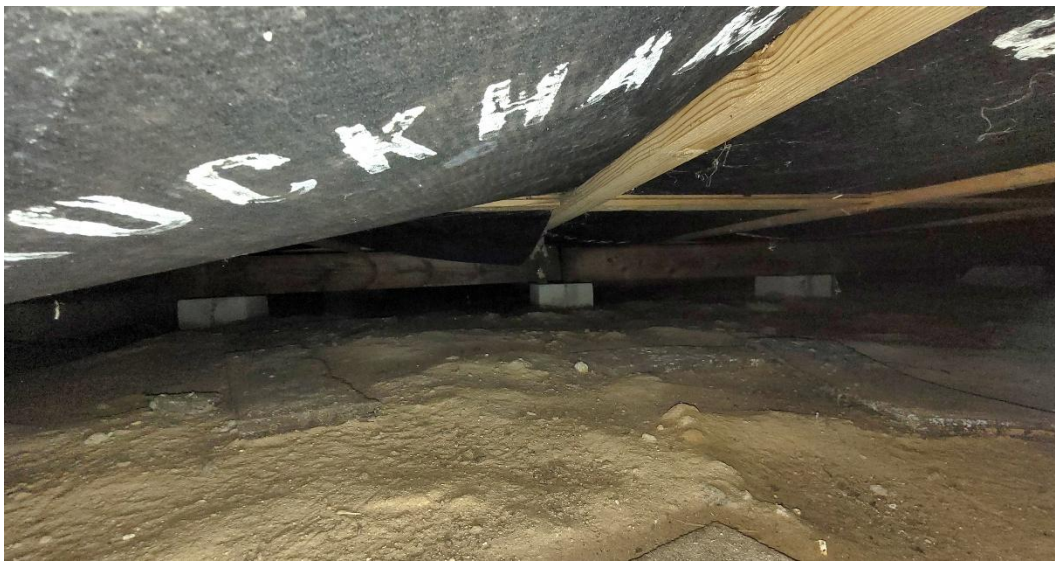
Geöffnete Schadensstellen: herabhängende Bodenplatten unter Küche / Wohnzimmer
