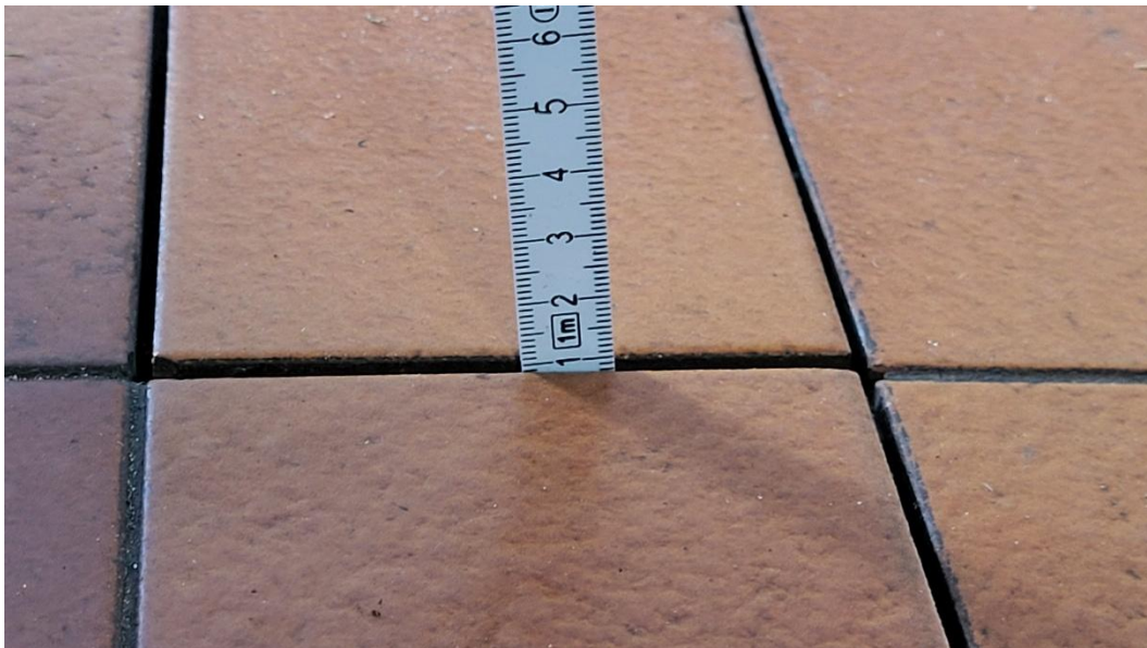
Küche: aufgewölbter Boden in Nähe zum Flur / Rissbildung der Bodenfliesen
