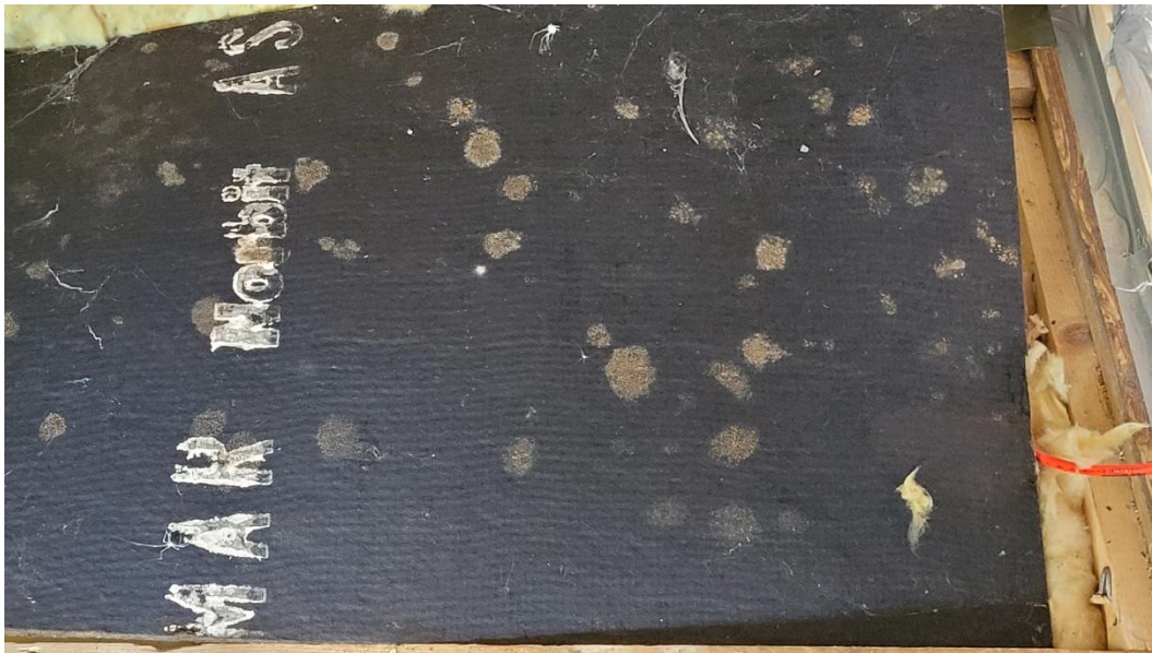
Wohnzimmer: Unterseite der Bodenplatte (Schimmelbefall)
