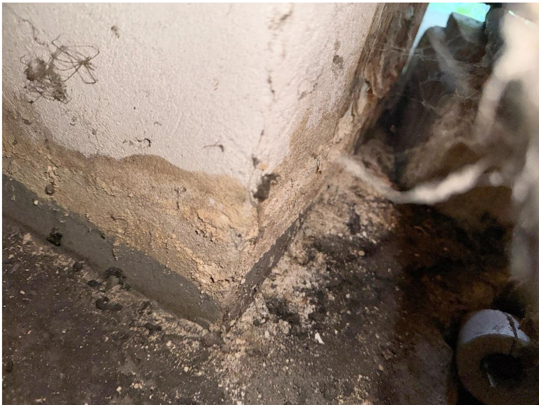
Heizungsraum: Fuß des Schornsteins
