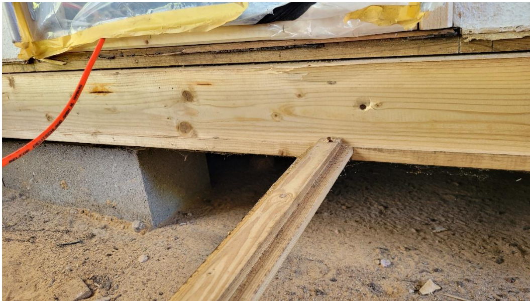
Geöffnete Schadensstellen: oben Zugang zum Wohn-/Esszimmer
