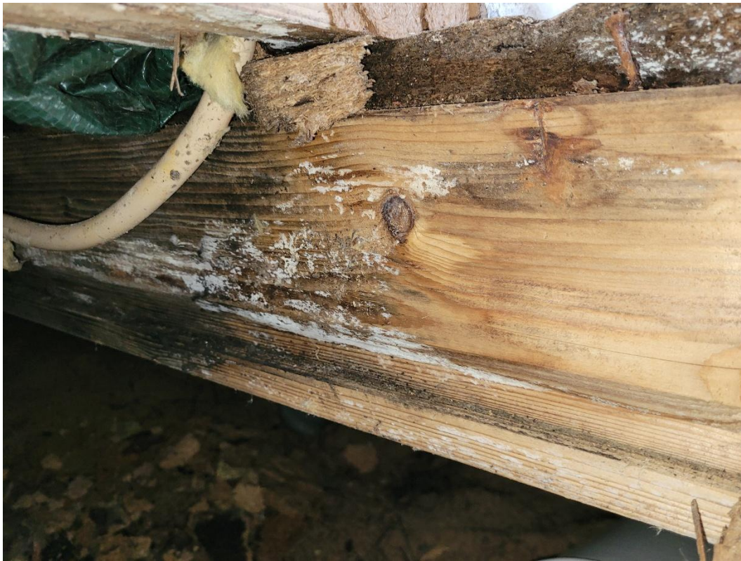
Schlafzimmer: Mycelbelag, Balkenrückseite von Bad aus fotografiert
