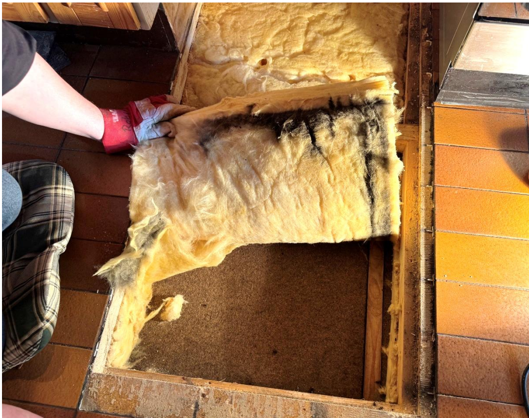
Küche: Dämmung unter dem Geschirrspüler
