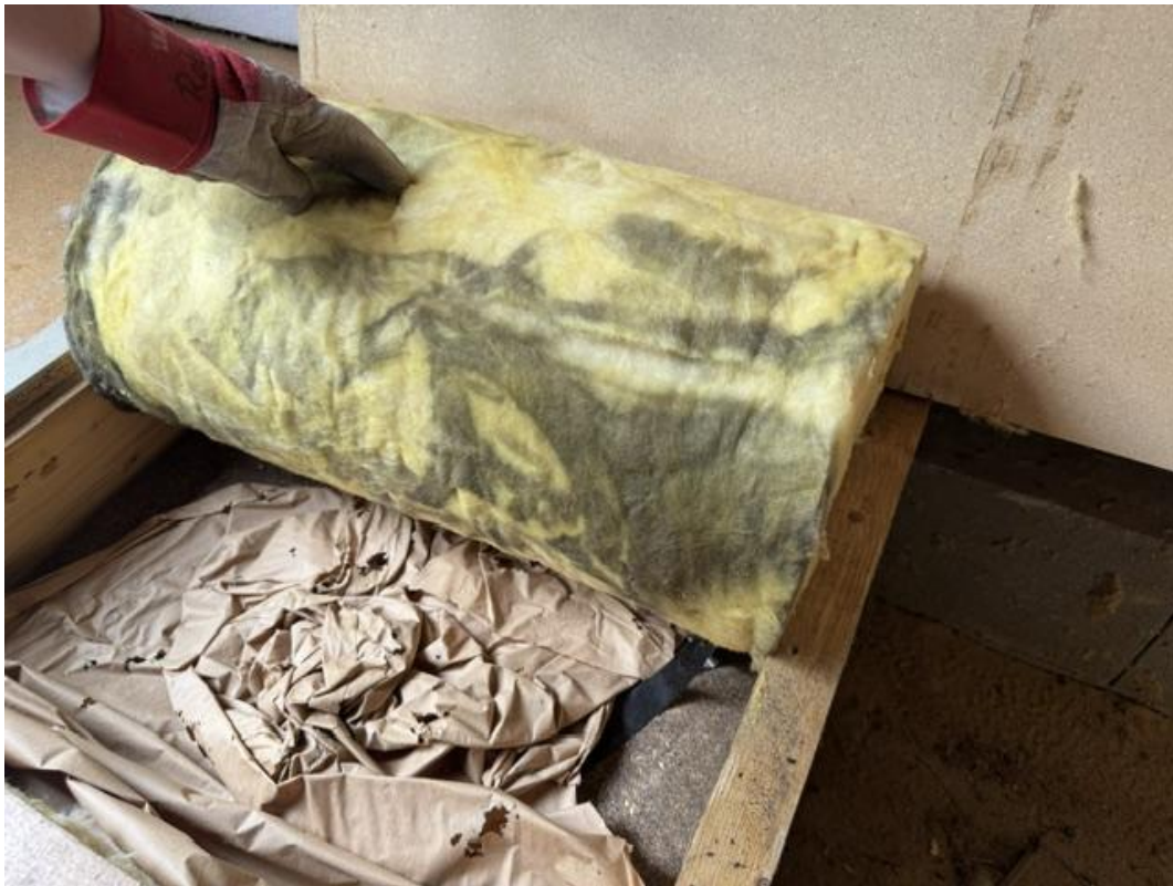
Wohnbereich: Schimmel auf der Unterseite der Dämmung / Herabhängende Bodenplatten / Dämmung / Erdreich mit Wasserlaufspuren
