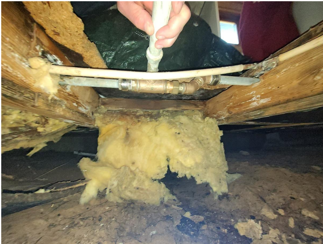
Holzschäden: Bodenunterseite / beschädigte Dämmung / beschädigte Balken, Holzwurm
