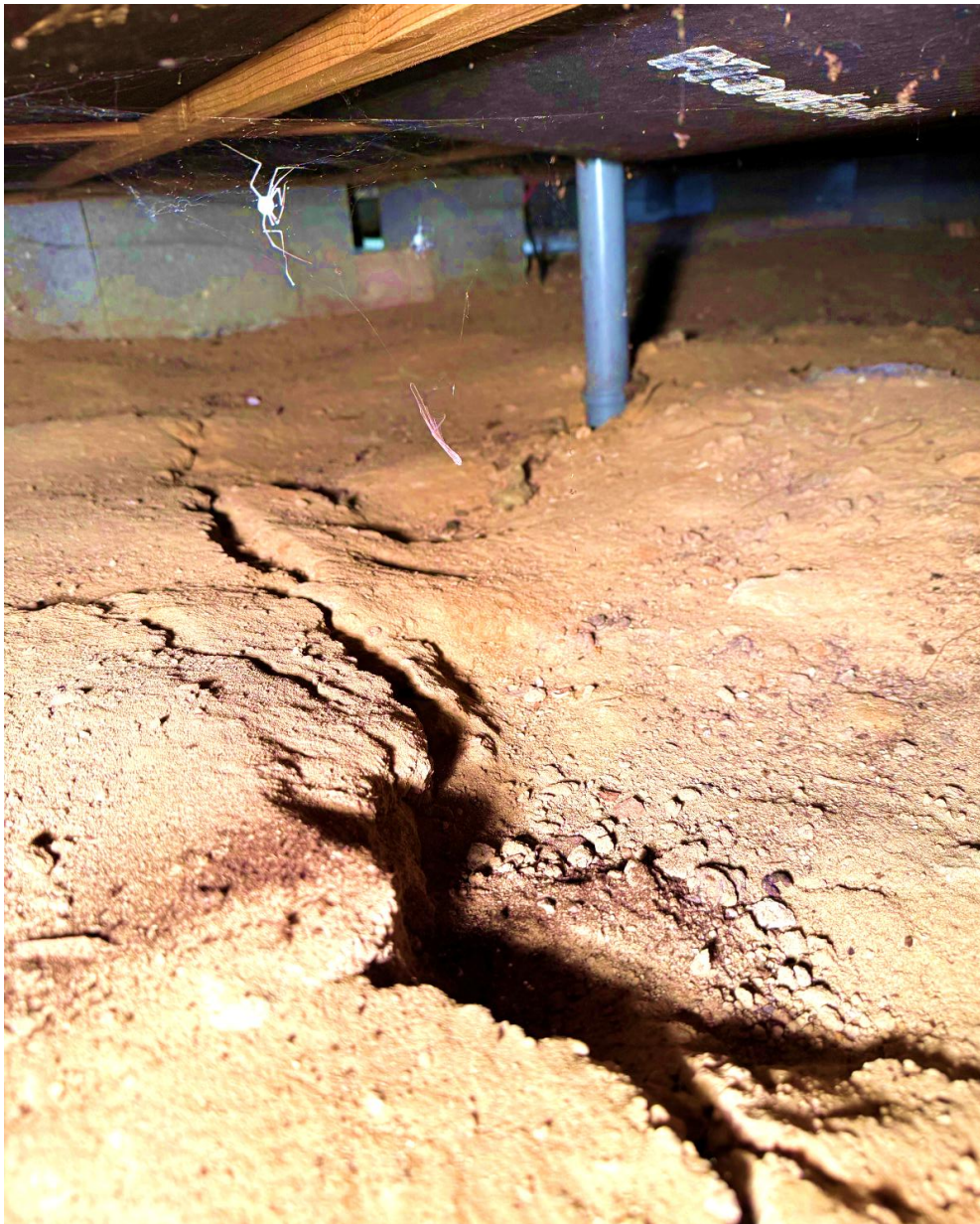
Küche: Erdreich mit Wasserlaufspuren unter dem Geschirrspüler
