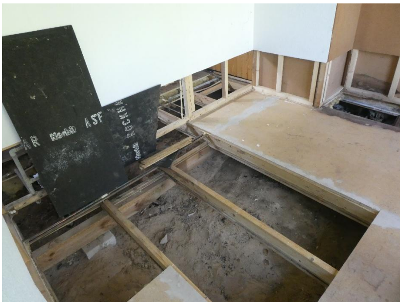
Foto Schlafzimmer Demontage im Bereich der Schadenstelle
