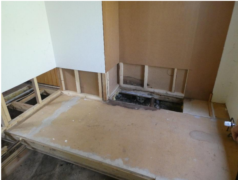
Foto Schlafzimmerwand zum Heizungsraum
