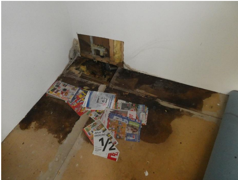
Foto Fußbodenbereich Schlafzimmer im Bereich der Schadenstelle vor der Demontage
